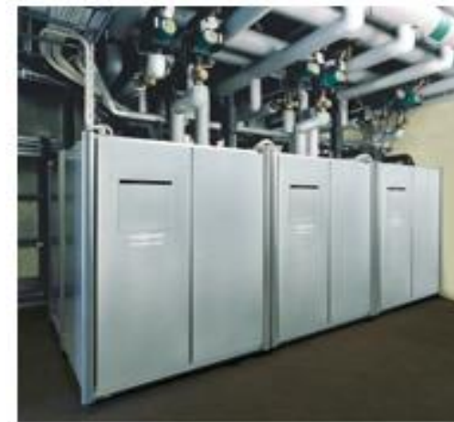
Instalace tepelná čerpadla 3x106 kW
